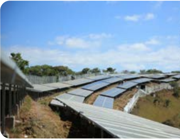
Paneles solares, laguna El Hoyo, Monjas Jalapa.
